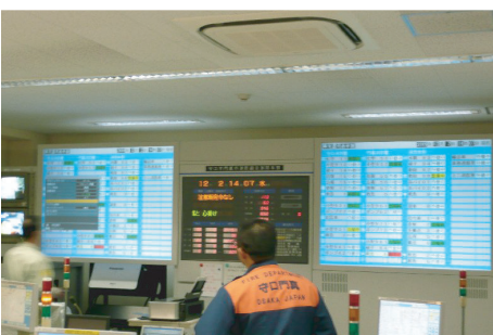
守口門真消防局司令室
